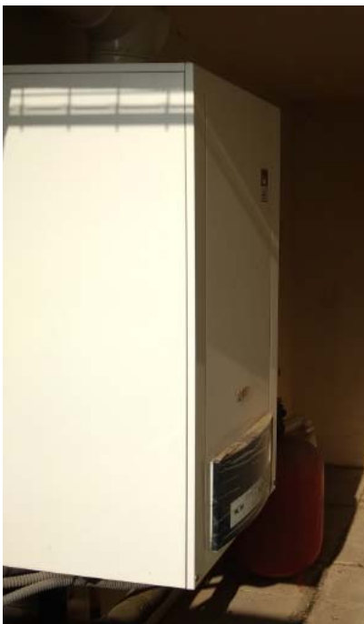
Imagen de la caldera de gas.
