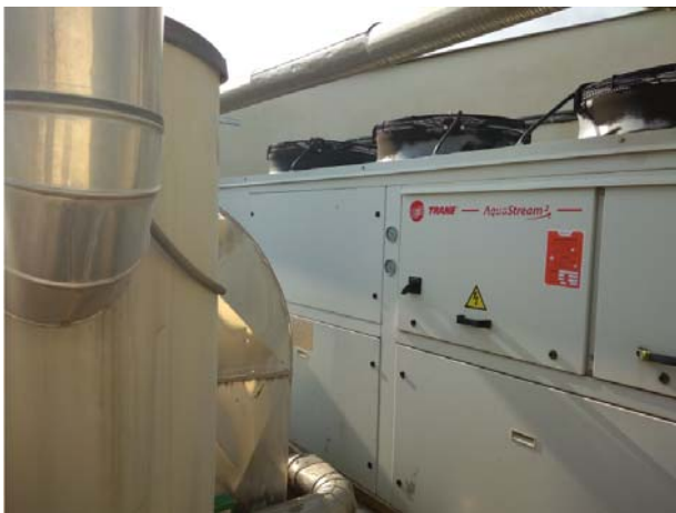
Imagen del equipo climatizador.
